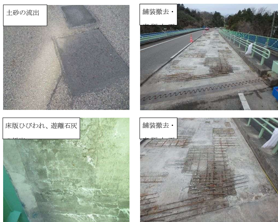
図-4 猿投グリーンロード（芝中橋） 床版等の劣化状況
