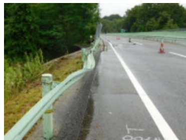
【事故発生時の現場状況】
