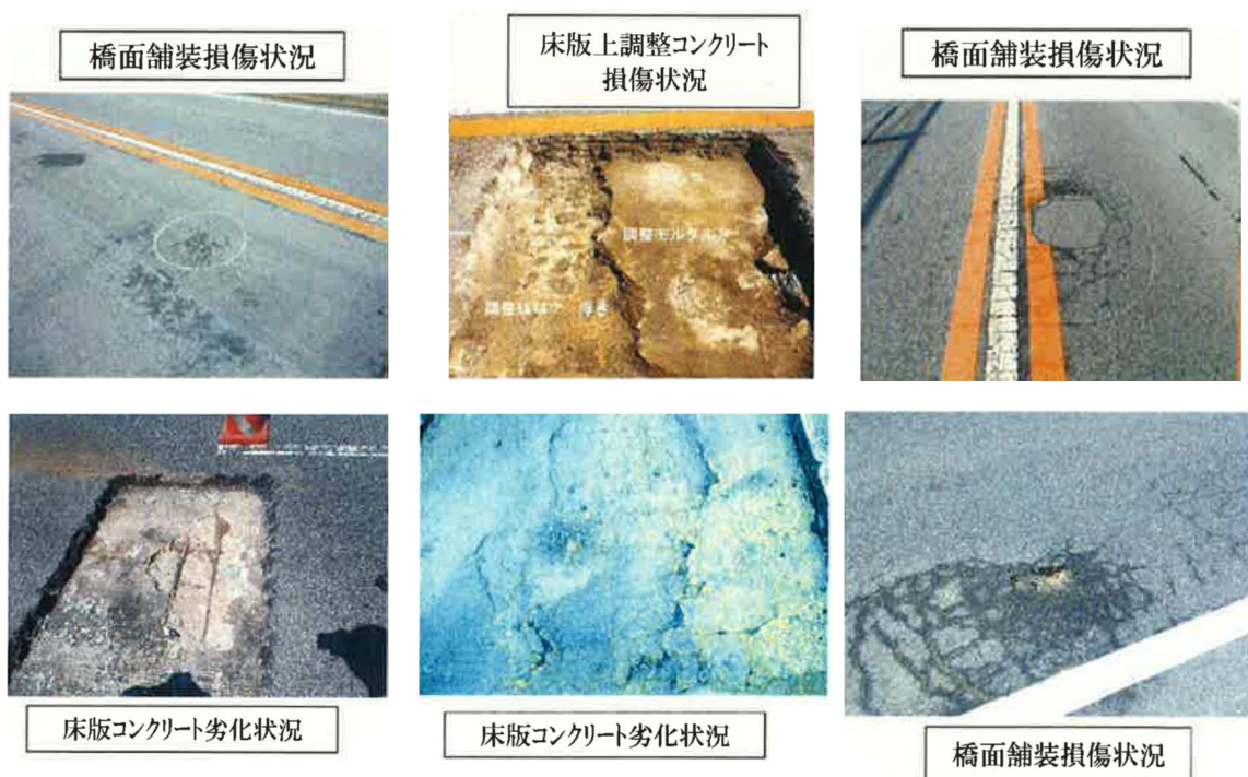
図-4 猿投グリーンロード 床版等の劣化状況
